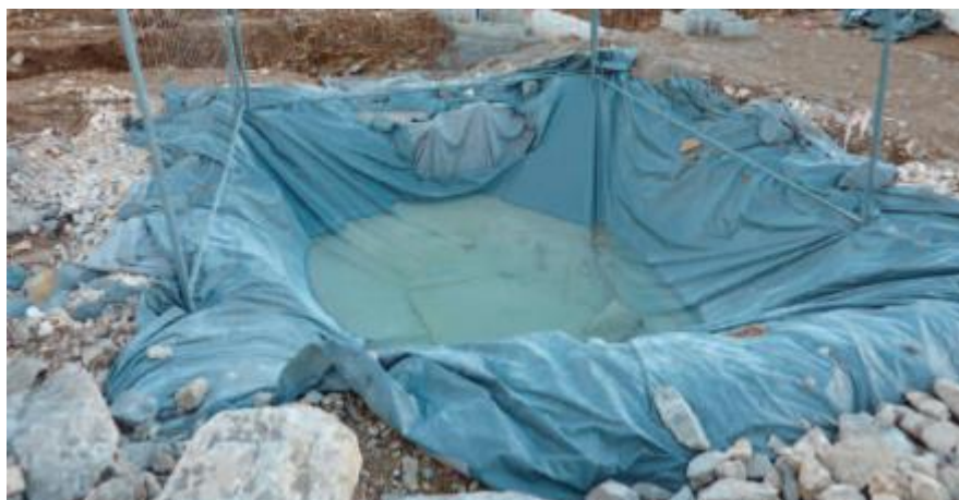
Figure 15 : Exemples de fosses étanches de récupération des résidus de nettoyage des goulottes des toupies béton.
